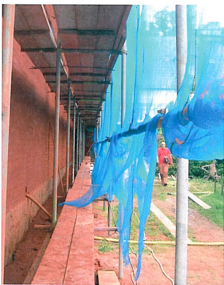
Vägaskolan av Gunnar Asplund renoveras. Det vackra röda pigmentet är järnoxider av typen Falurött pigment.
